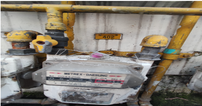
Contador de Gas
