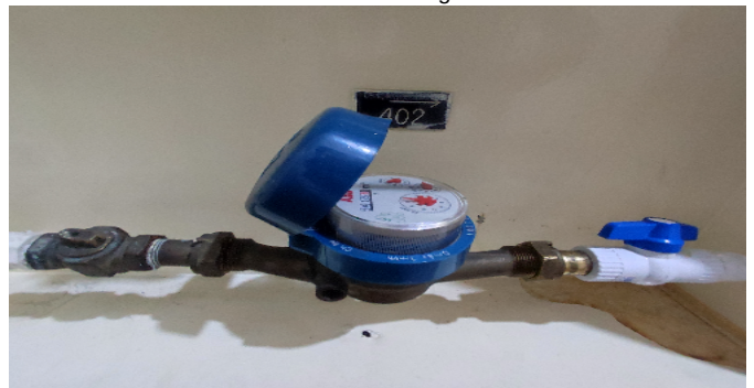
Contador de Agua
