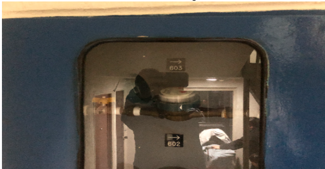
Contador de Agua
