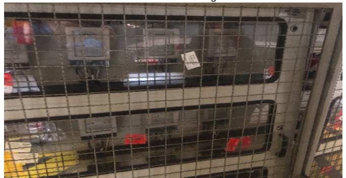
Contador de Energia
