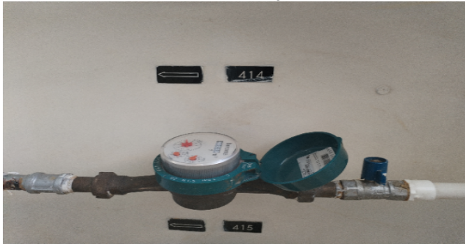
Contador de Agua
