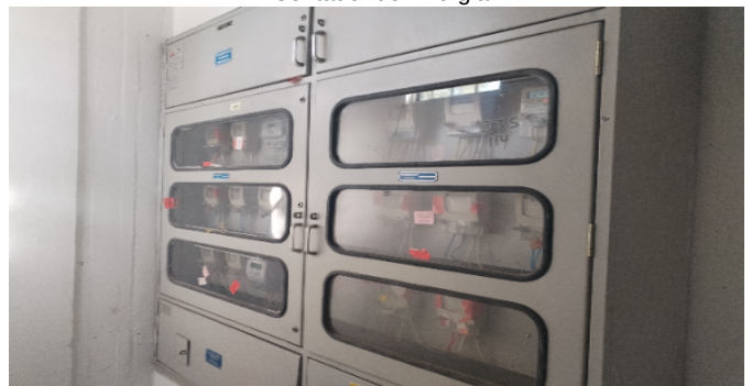
Contador de Energia
