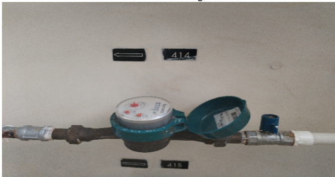
Contador de Agua
