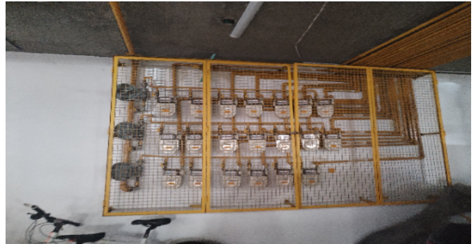
Contador de Gas
