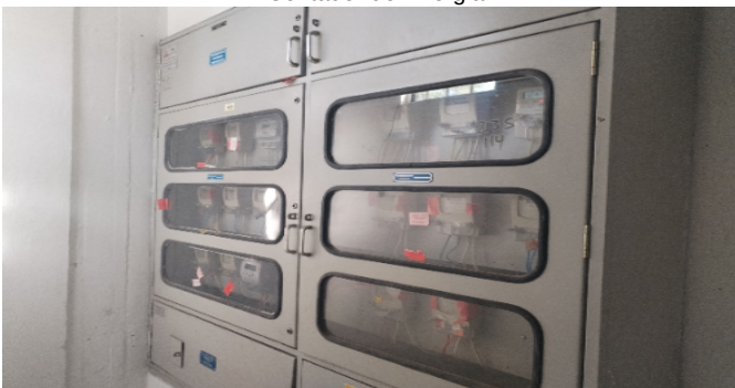
Contador de Energia
