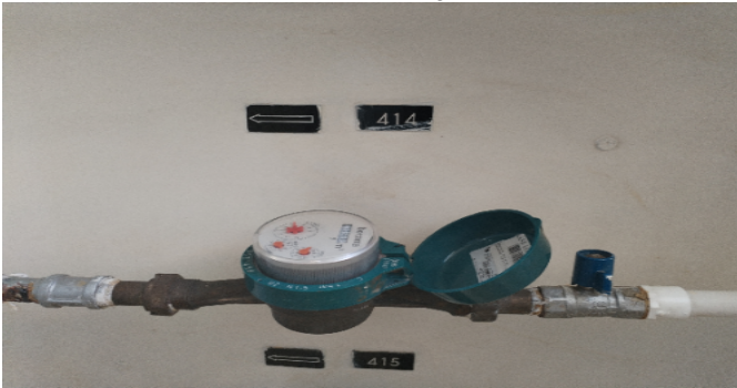
Contador de Agua
