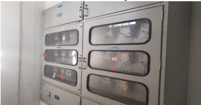
Contador de Energia
