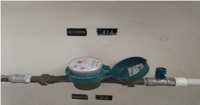
Contador de Agua
