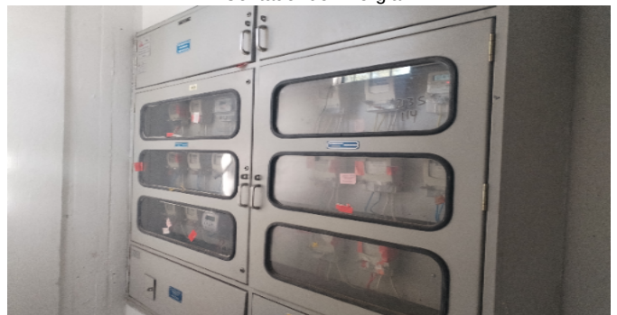
Contador de Energia
