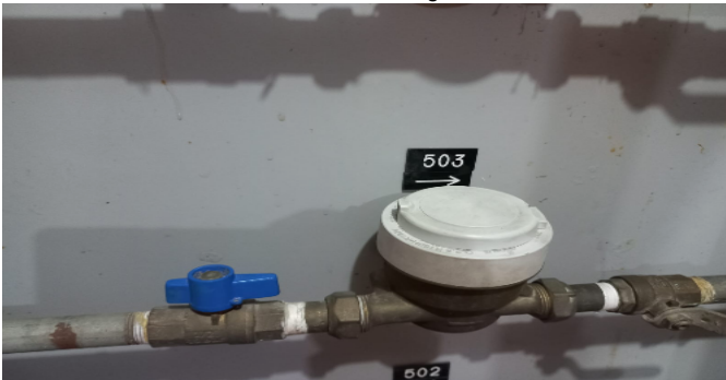
Contador de Agua
