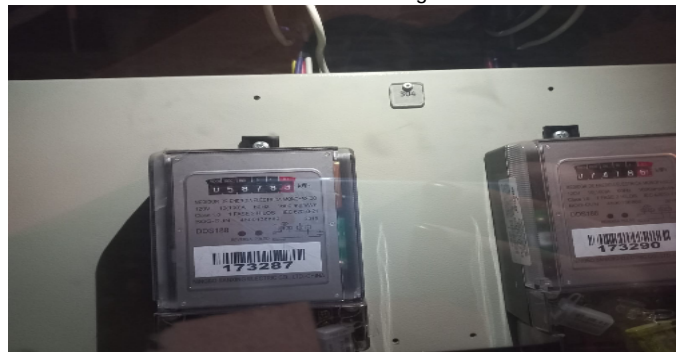
Contador de Energia
