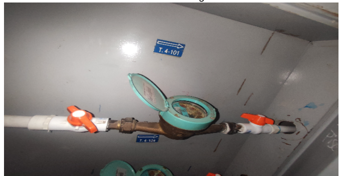
Contador de Agua
