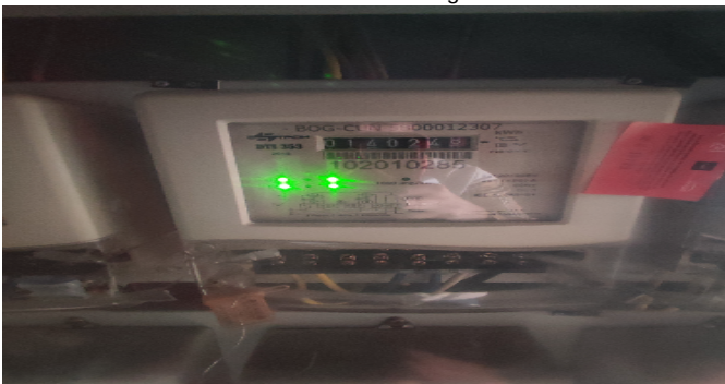
Contador de Energia
