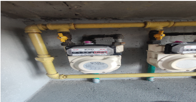
Contador de Gas
