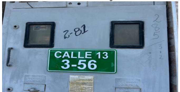
Contador de Energia
