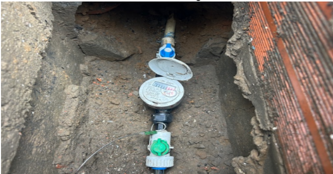
Contador de Agua
