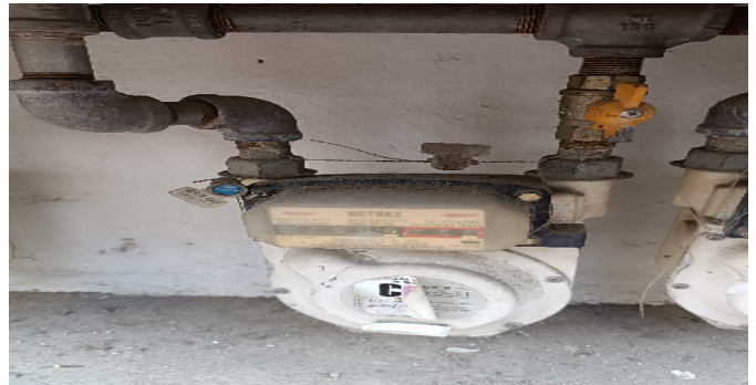
Contador de Gas
