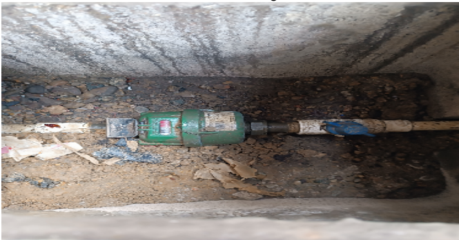
Contador de Agua
