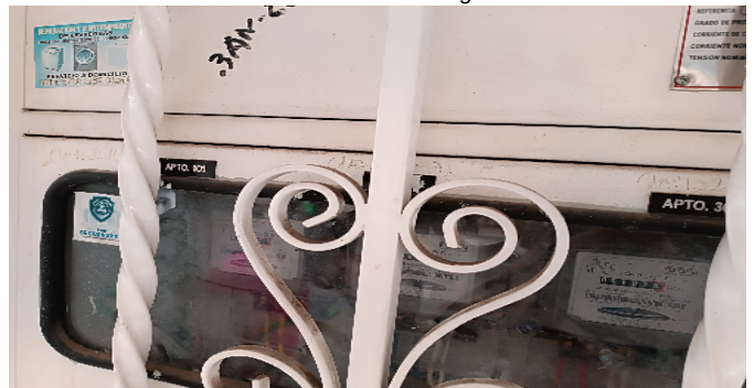
Contador de Energia
