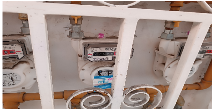
Contador de Gas
