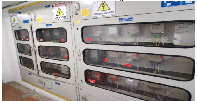
Contador de Energia
