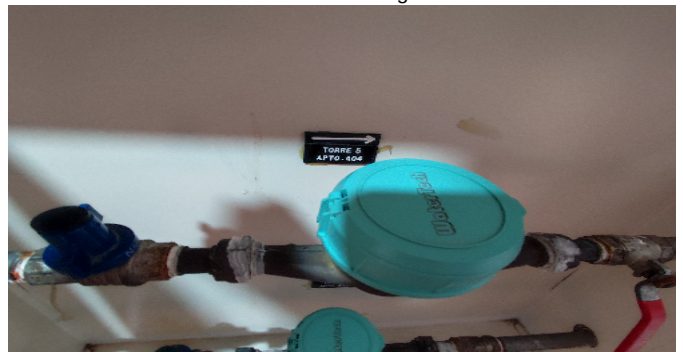
Contador de Agua
