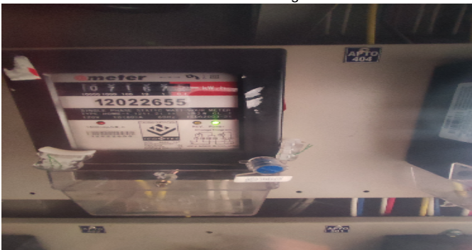
Contador de Energia
