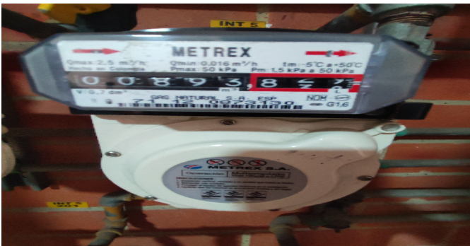
Contador de Gas
