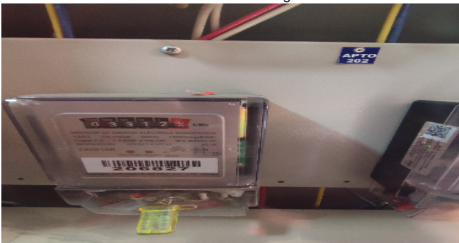
Contador de Energia
