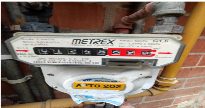
Contador de Gas
