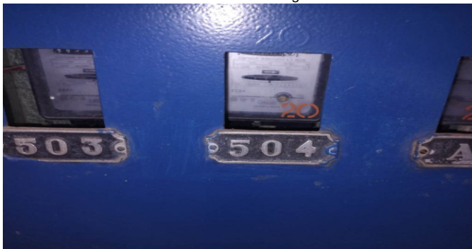
Contador de Energia
