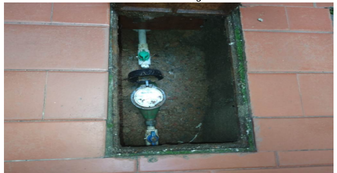
Contador de Agua
