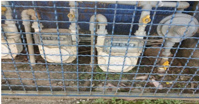
Contador de Gas
