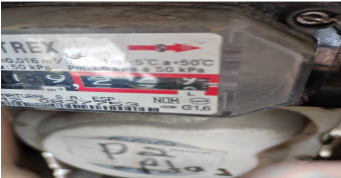
Contador de Gas
