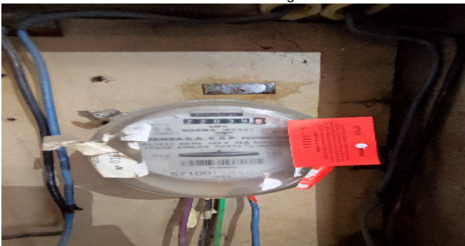
Contador de Energia
