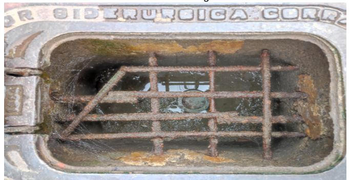
Contador de Agua
