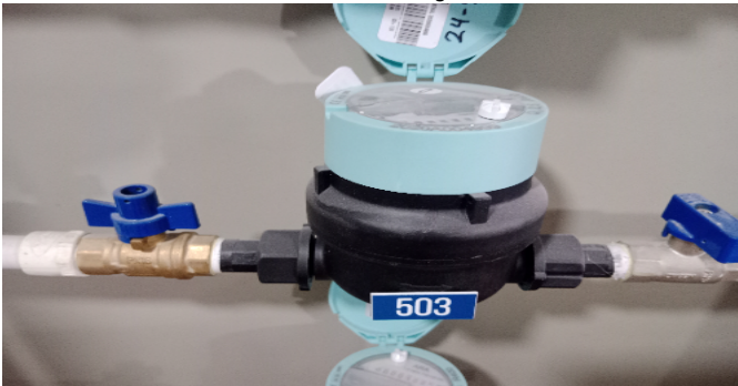
Contador de Agua
