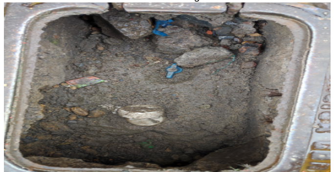
Contador de Agua
