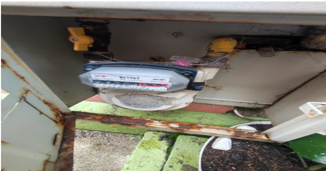
Contador de Gas
