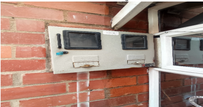
Contador de Energia
