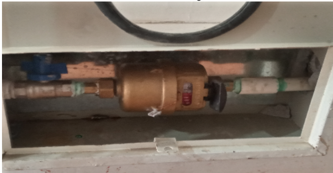
Contador de Agua
