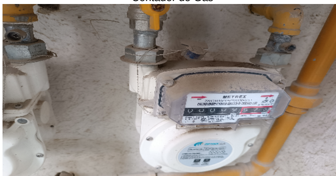
Contador de Gas
