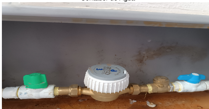
Contador de Agua
