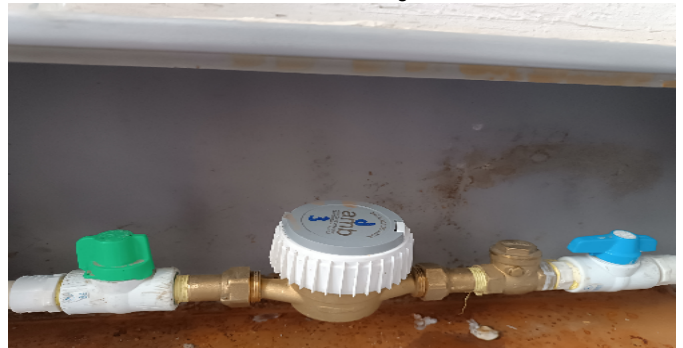
Contador de Agua
