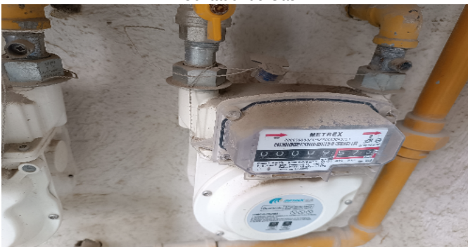
Contador de Gas
