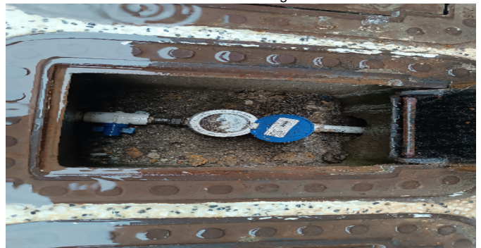
Contador de Agua
