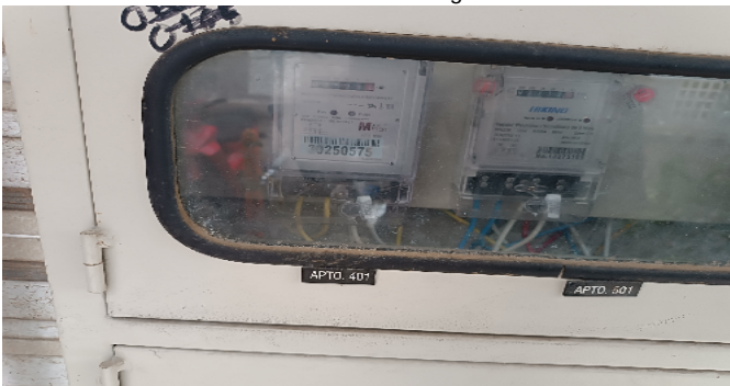
Contador de Energia
