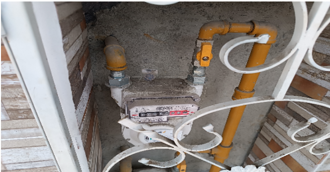
Contador de Gas
