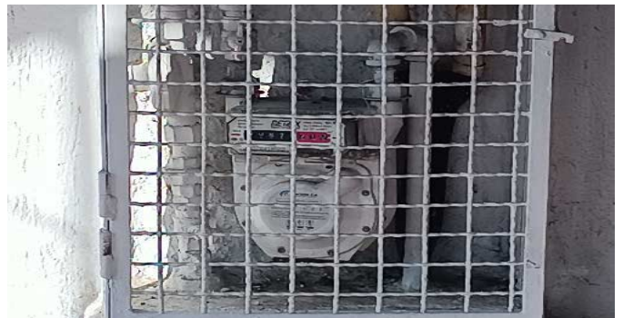
Contador de Gas
