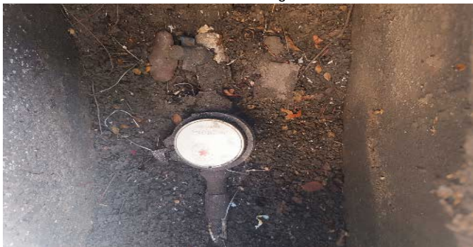
Contador de Agua
