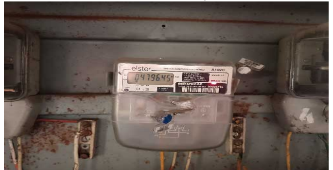
Contador de Energia
