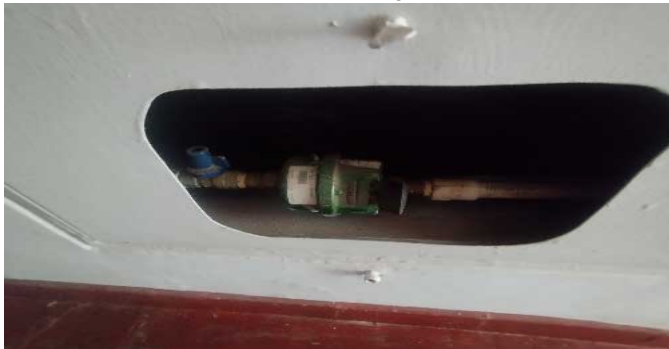
Contador de Agua
