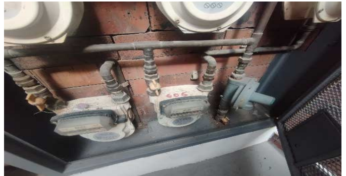
Contador de Gas
