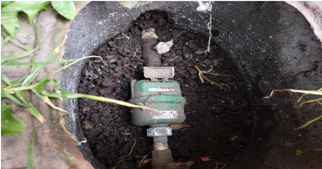
Contador de Agua
