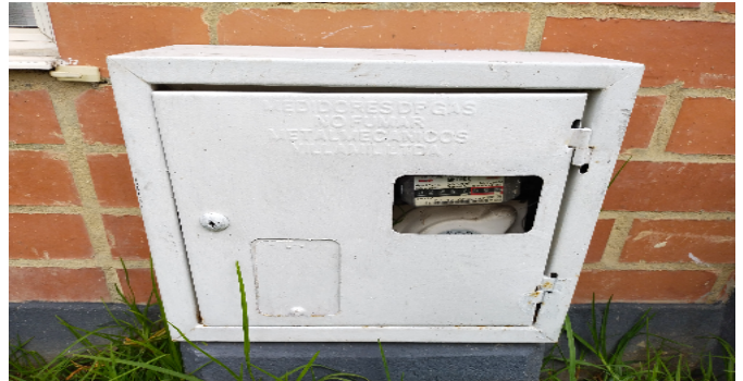
Contador de Gas
