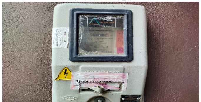
Contador de Energia
