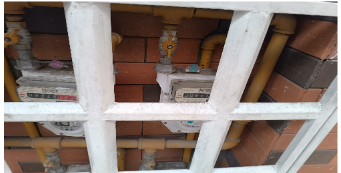
Contador de Gas
