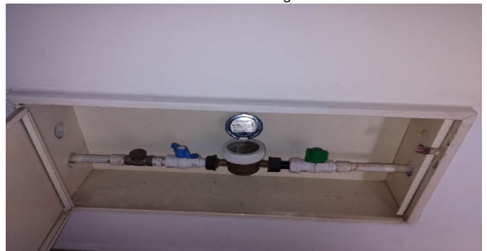
Contador de Agua
