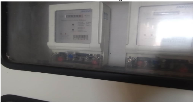
Contador de Energia
