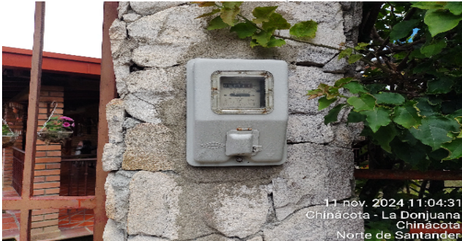
Contador de Energia
