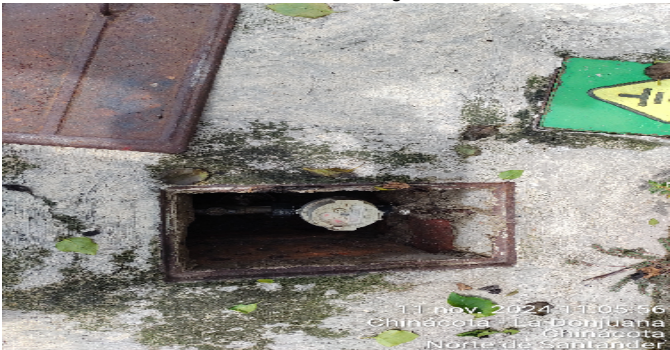
Contador de Agua
