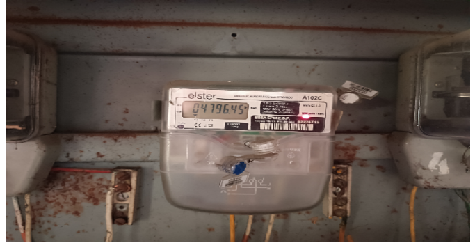
Contador de Energia
