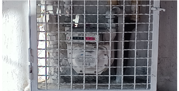
Contador de Gas
