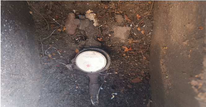
Contador de Agua
