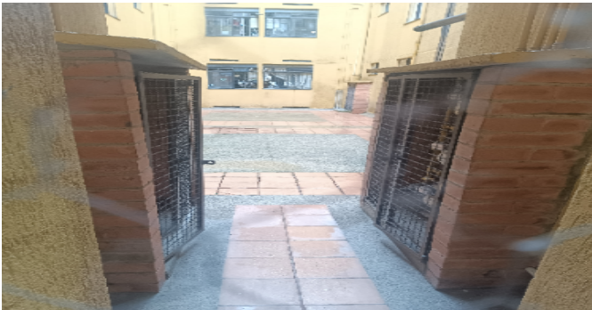
Contador de Gas
