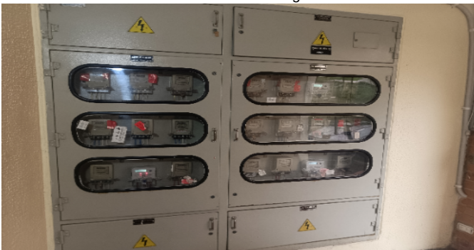
Contador de Energia
