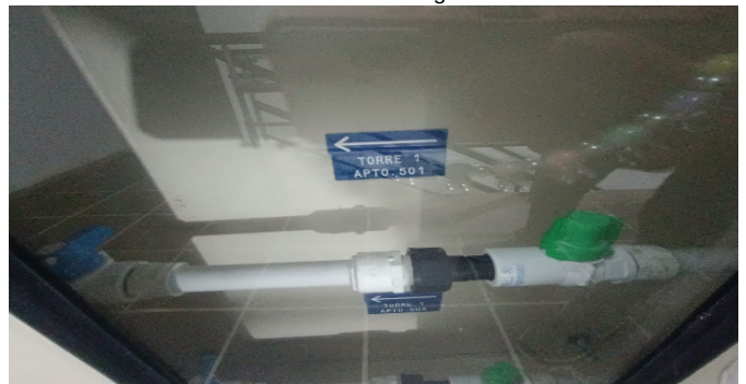
Contador de Agua
