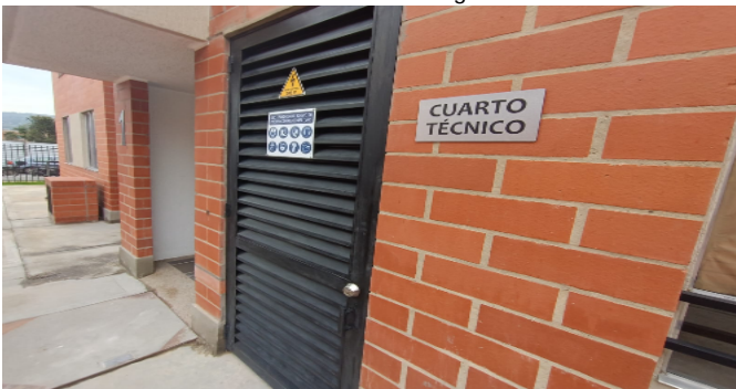
Contador de Energia
