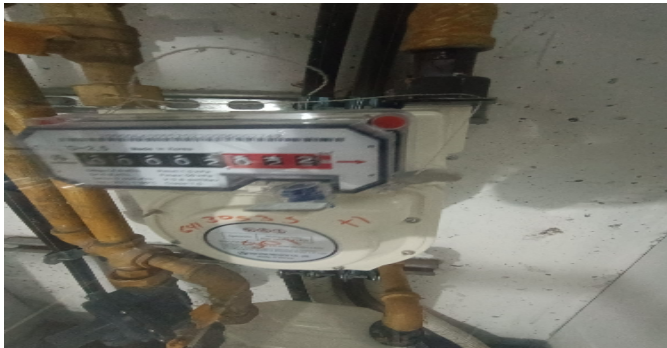
Contador de Gas
