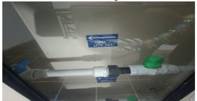
Contador de Agua
