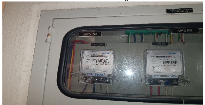
Contador de Energia
