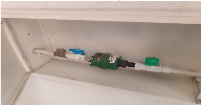
Contador de Agua
