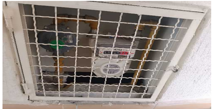
Contador de Gas
