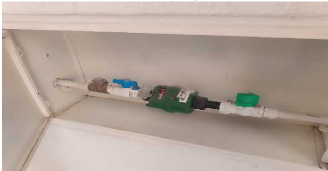
Contador de Agua
