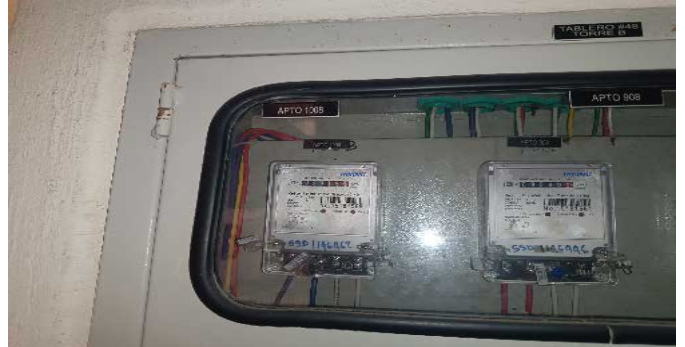
Contador de Energia
