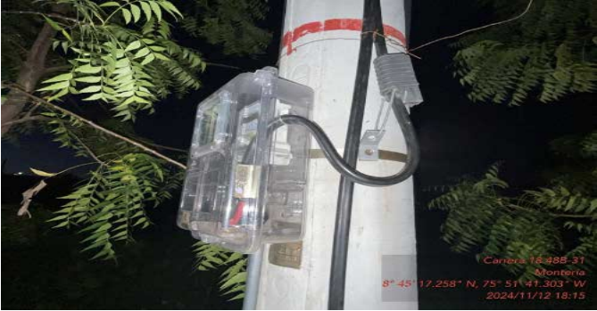
Contador de Energia
