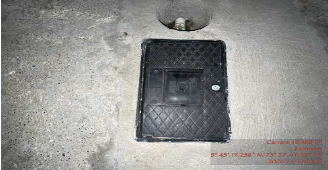
Contador de Agua
