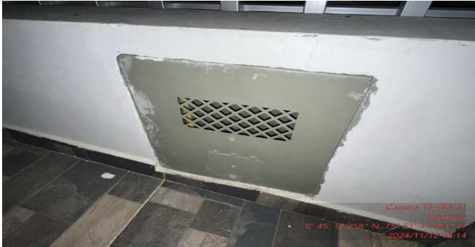
Contador de Gas
