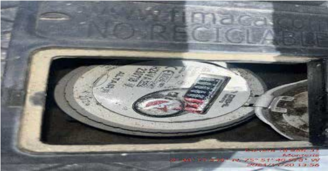
Contador de Agua
