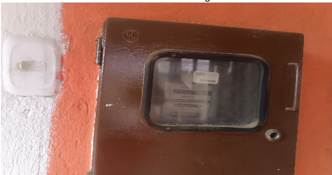
Contador de Energia
