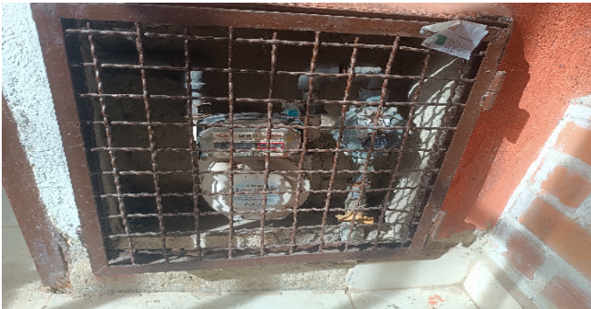
Contador de Gas
