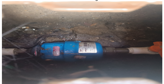
Contador de Agua
