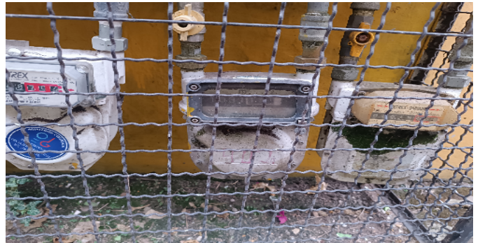
Contador de Gas
