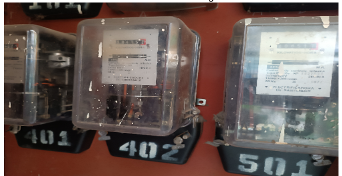
Contador de Energia
