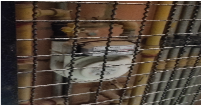
Contador de Gas
