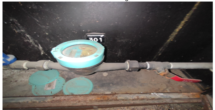
Contador de Agua
