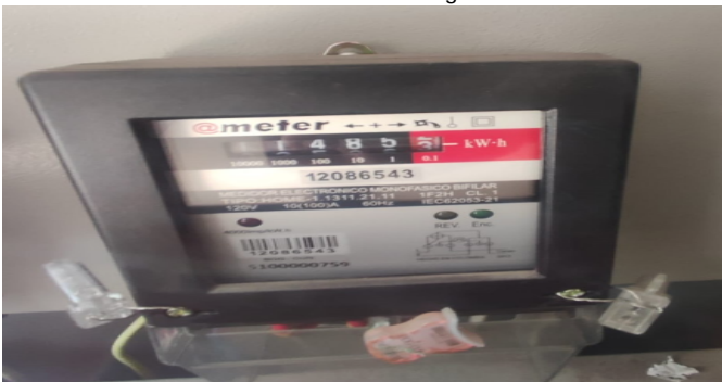
Contador de Energia
