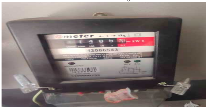
Contador de Energia
