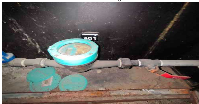
Contador de Agua
