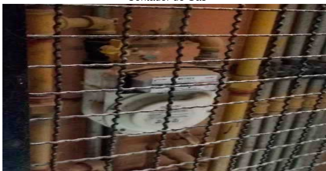
Contador de Gas
