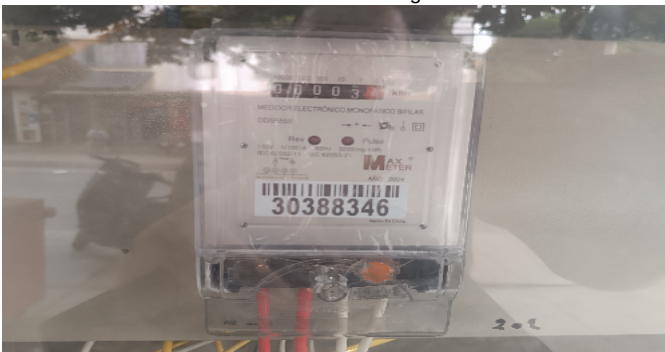
Contador de Energia
