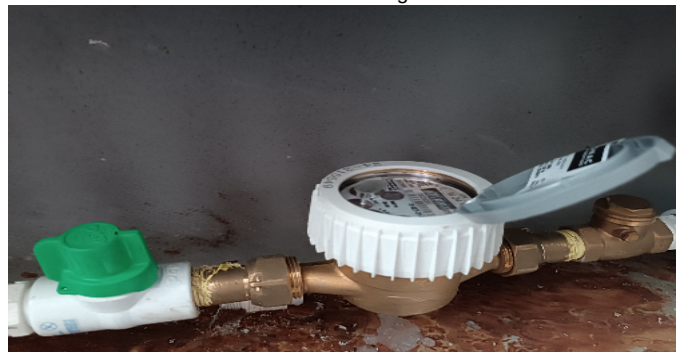
Contador de Agua
