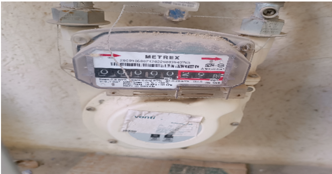
Contador de Gas
