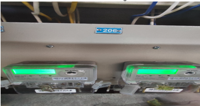
Contador de Energia
