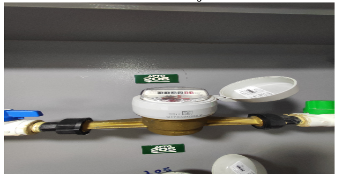
Contador de Agua
