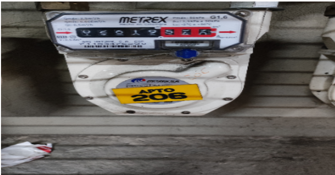
Contador de Gas
