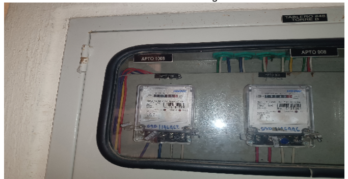
Contador de Energia
