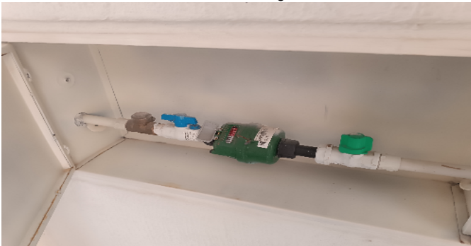
Contador de Agua
