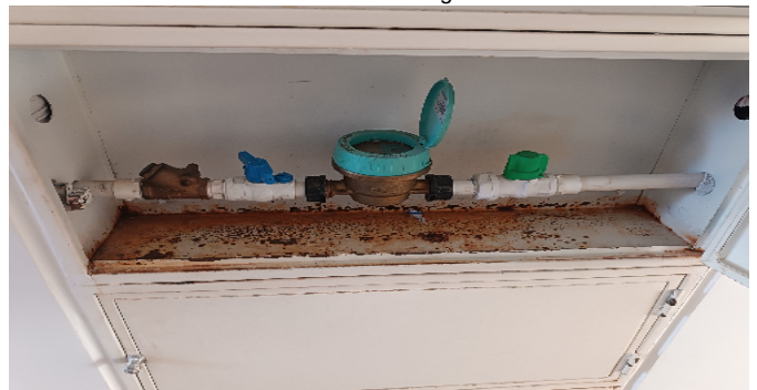
Contador de Agua
