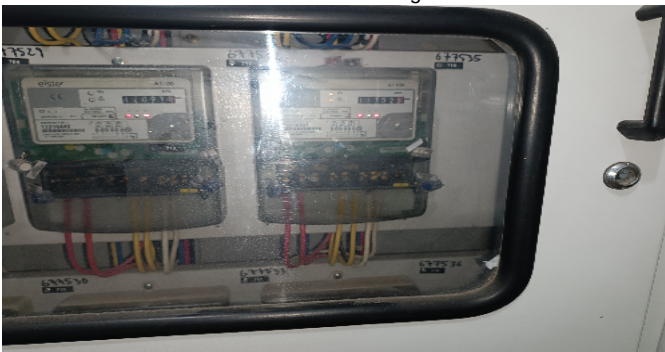
Contador de Energia
