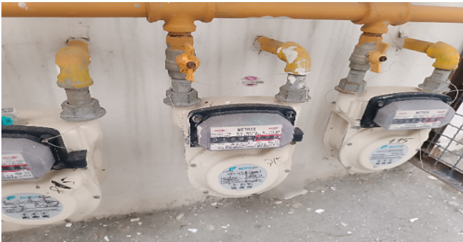
Contador de Gas
