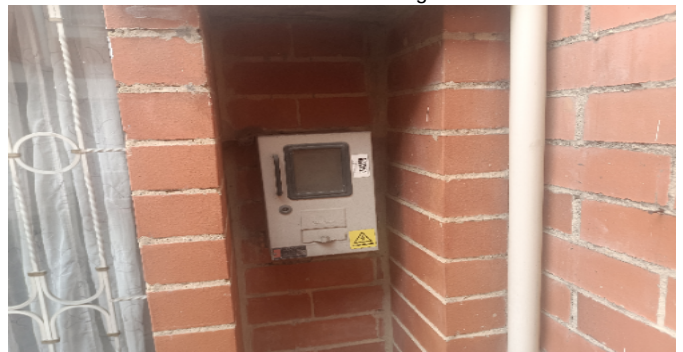
Contador de Energia
