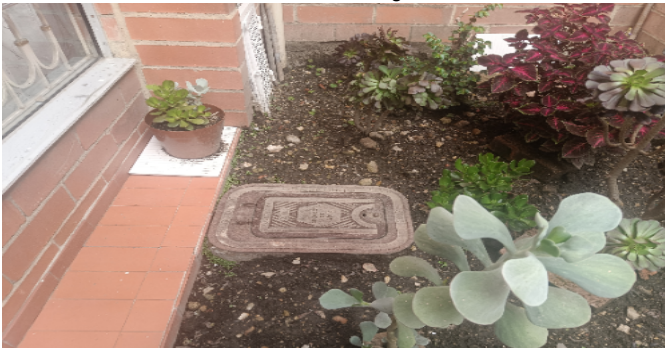
Contador de Agua
