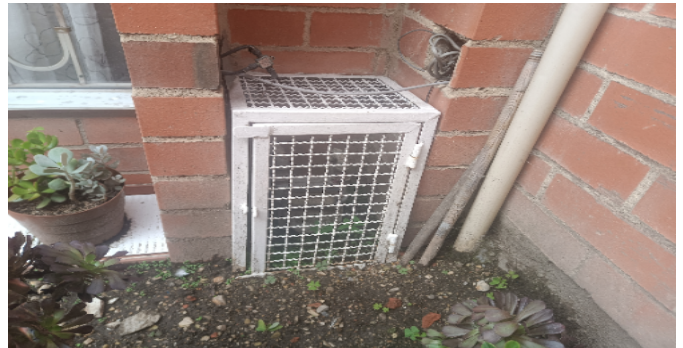
Contador de Gas
