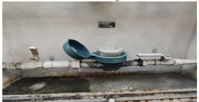
Contador de Agua
