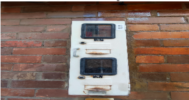
Contador de Energia
