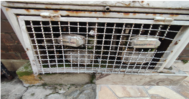
Contador de Gas
