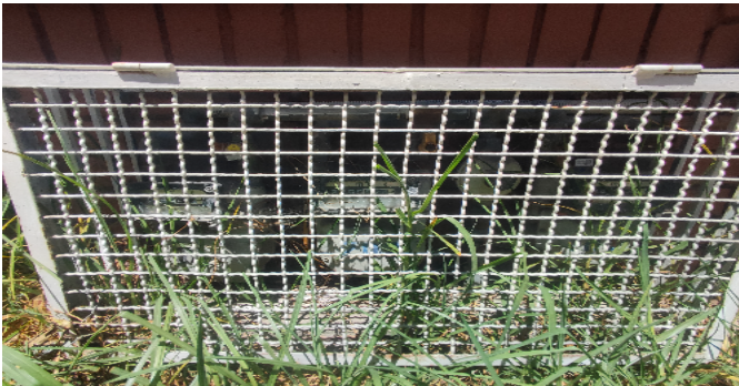
Contador de Gas
