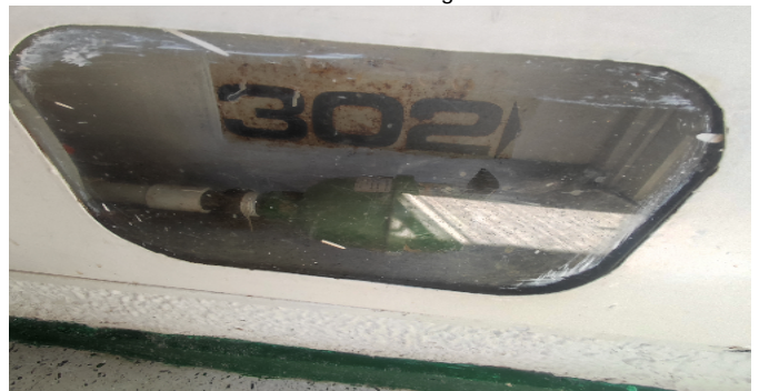
Contador de Agua
