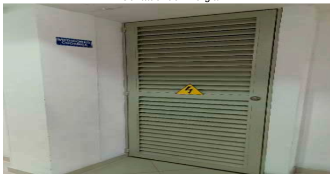
Contador de Energia
