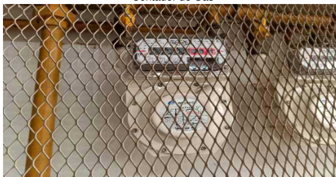
Contador de Gas
