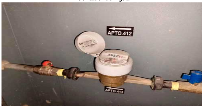
Contador de Agua
